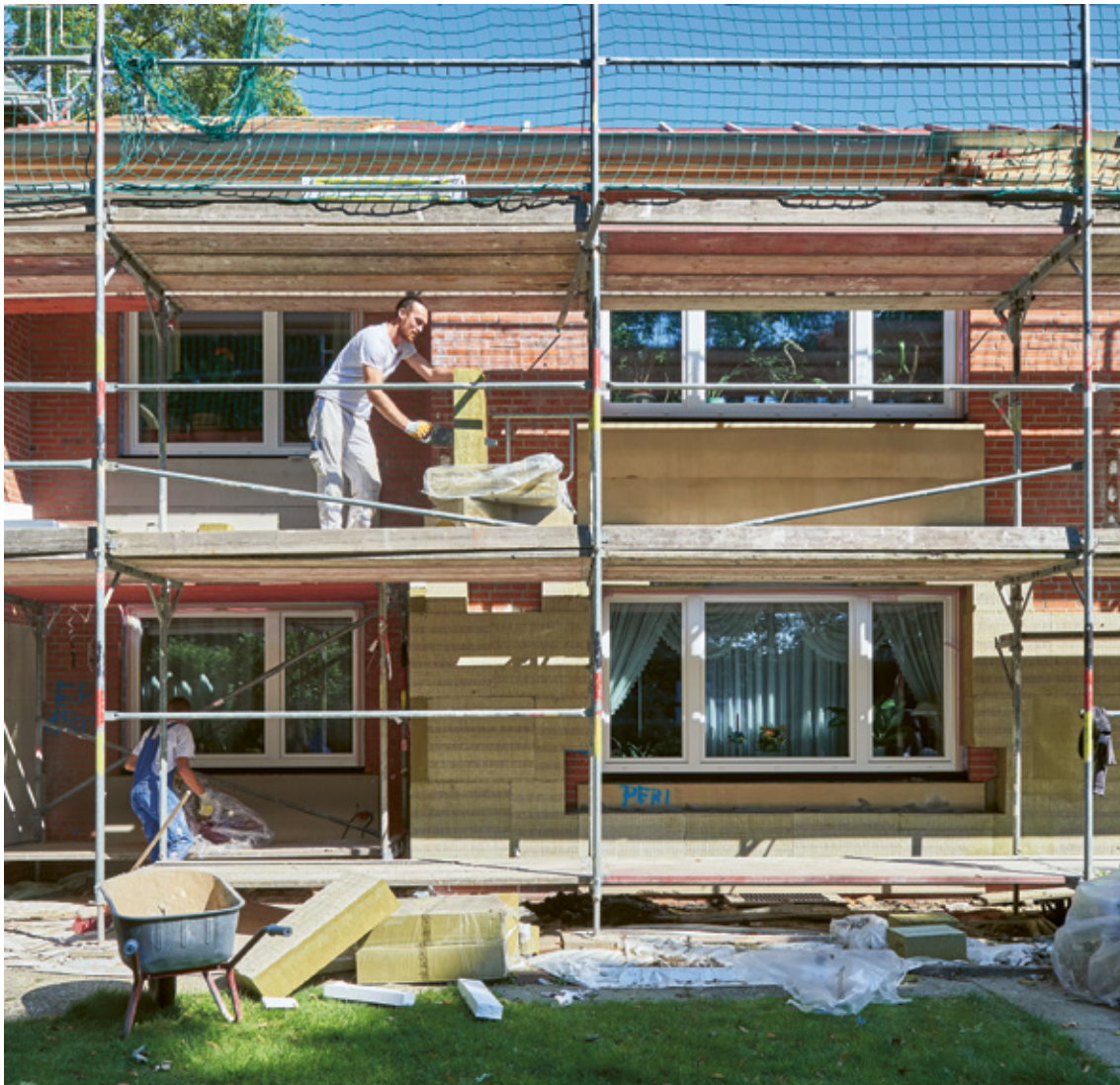
Im Jahr 2020 wird der vierte Bauabschnitt der energetischen Modernisierung der Hans-Schwenkel-Wohnanlage fertig.
